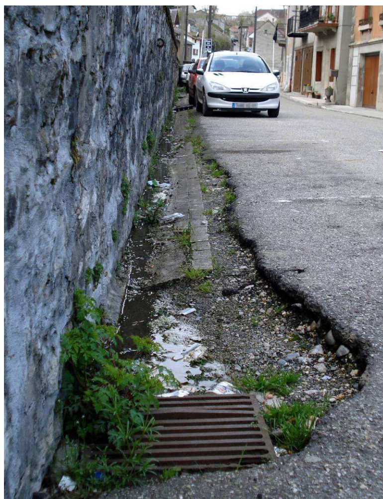
Photo 26 : Etat délabré du caniveau longeant le Boulevard Bonivard
