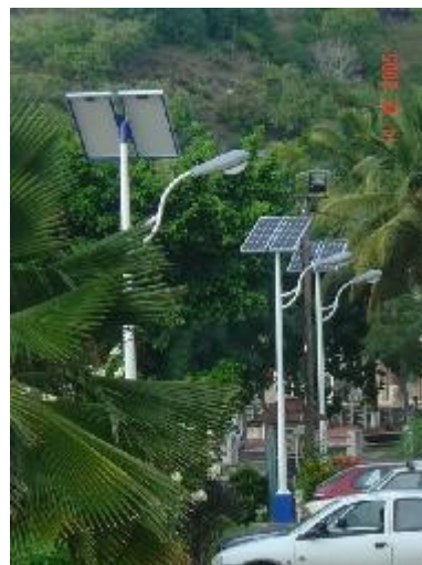
Des lampadaires photovoltaïques à Bellefontaine, source: mctsolaire.com
