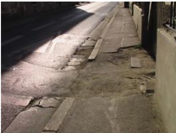
11- Etat de la chaussée en séquence 2
