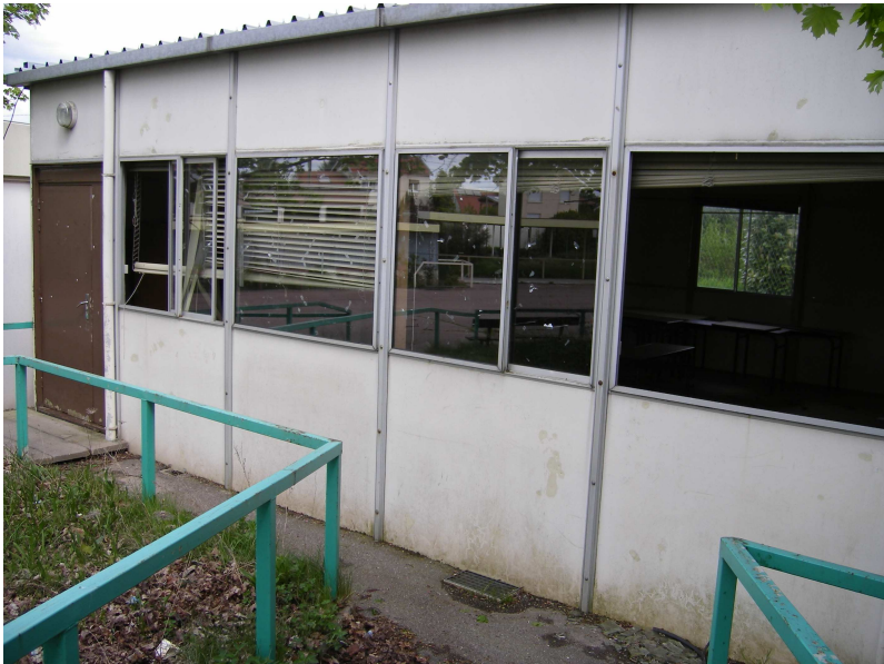
Salle préfabriquée vandalisée
