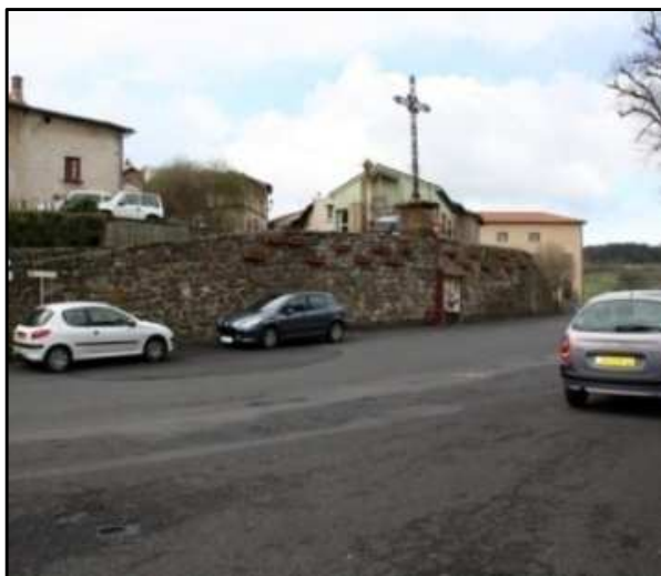
Photographie 20 : mur sans garde corps.
