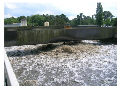
Traitement biologique – bassin d'aération Source : NDiugou
