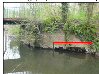
Figure 23: Bajoyers endommagés de la passerelle OH18 (encadré rouge).
