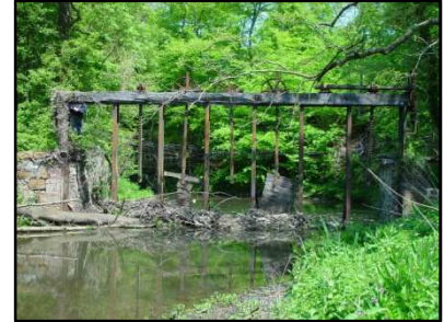
Figure 7: Vue amont d'OH17a embâclé.
