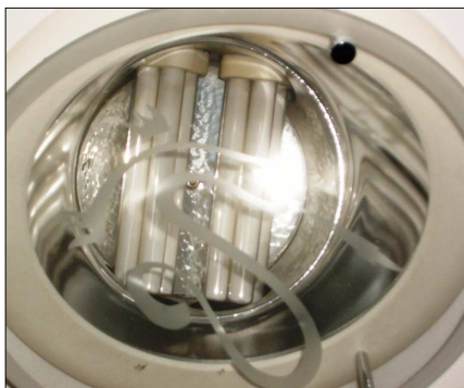
Figure 19 : Plafonnier muni d'ampoules fluocompactes (extension de l'Hôtel du Département)
