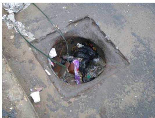
Photo 12 : Bouche d'égout obstruée par des déchets solides
