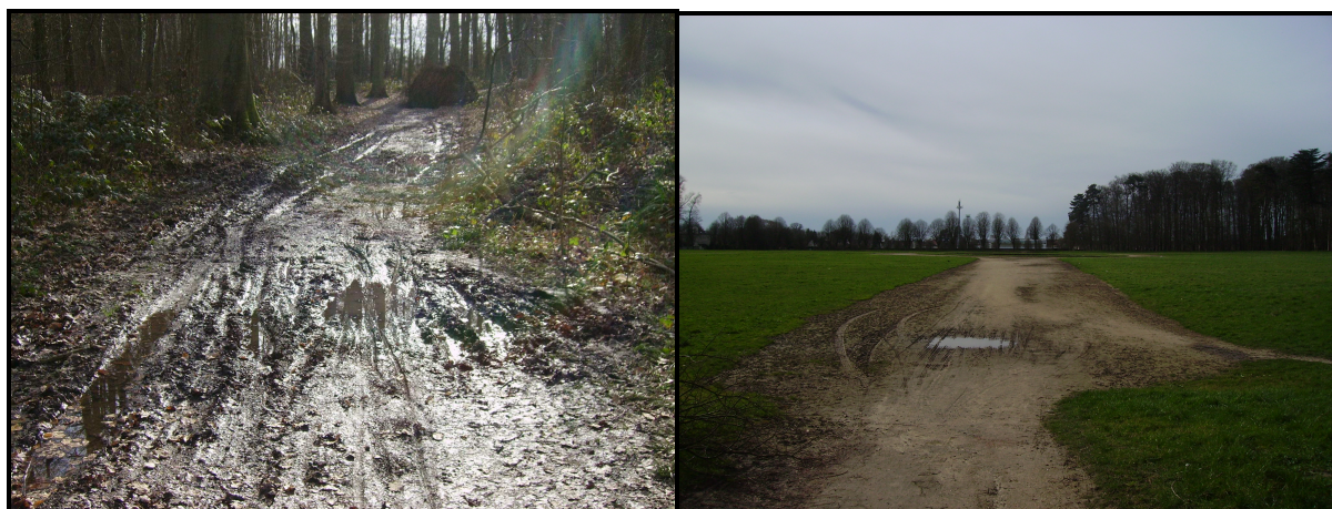
Photo n°6 : Chemin du parcours de santé abîmé par la pluie et le passage de véhicules
