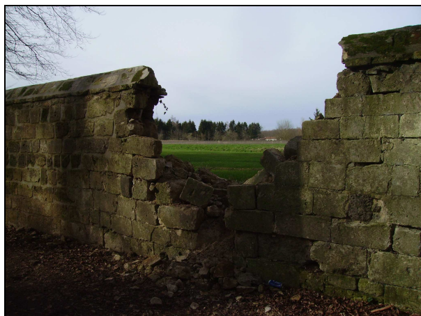
Photo n°8 : Mur d'enceinte en ruine à certains endroits à cause des chutes d'arbres Source personnelle
