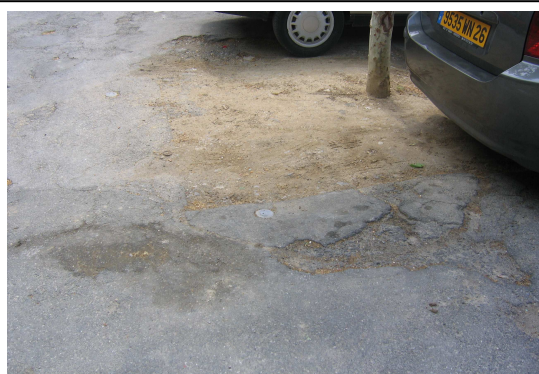
Doc.17: Le revêtement de sol dégradé
