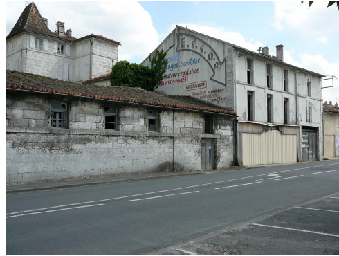
Photo n°44 : bâtiments en mauvais état
