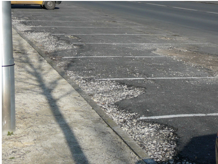
Photo n°31 : la chaussée est en mauvais état
