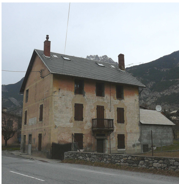
Figure 34 : maison de la zone 2 dont l'état des façades laisse à désirer.
