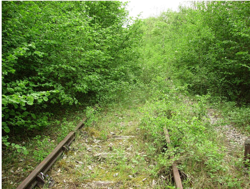
Portion de la voie envahie par la végétation
