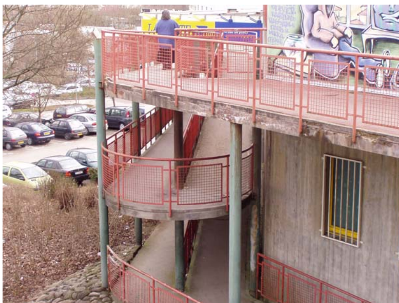
Photo C : Plate-forme qui permet aux PMR ou aux personnes qui possèdent des poussettes d'accéder à l'arrêt de bus
