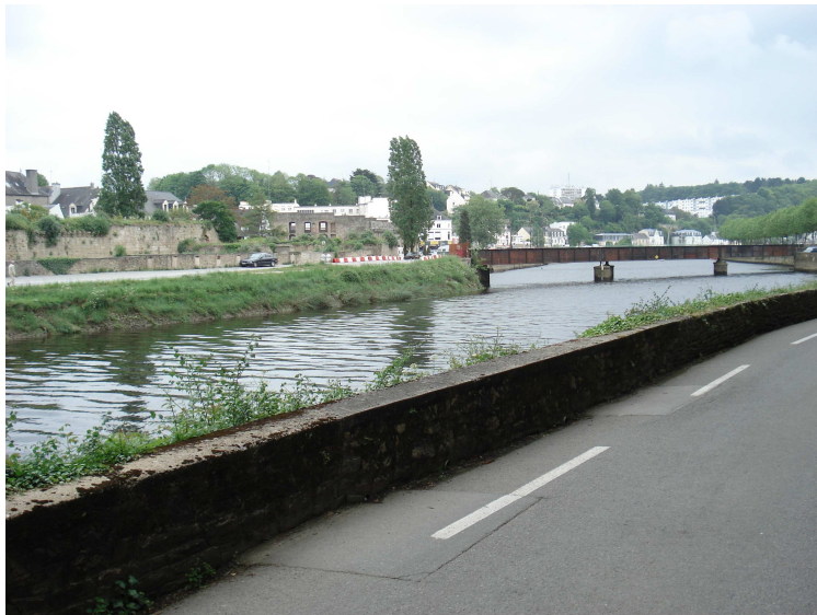
Photo 15: Pont de fer rouillé et remparts fortement dégradés
