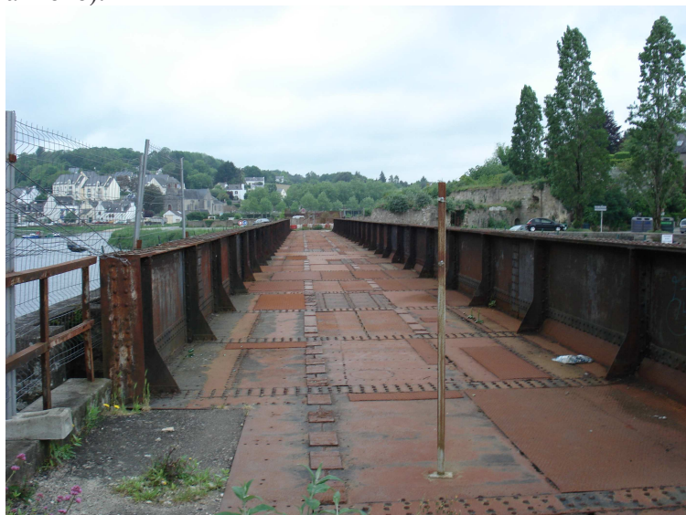
Photo 14: Dégradation du pont de fer rongé par la corrosion
