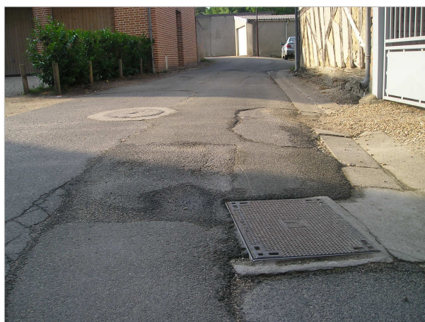
Photo 46 : état du revêtement du sol, rue des Petits Souliers.
