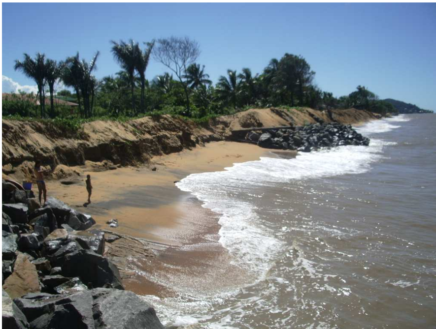
Fig.19: Erosion importante entre deux enrochements.
