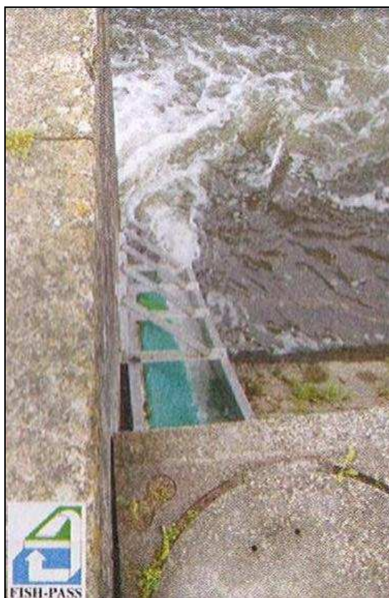
Figure 42 : Photographie d'une asse à anguillettes : gouttière humide munie d'un tapis brosse (fish-pass)
