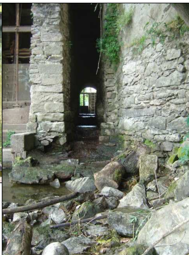
Figure 26 : Coursier emprunté par les anguilles lors de la montaison
