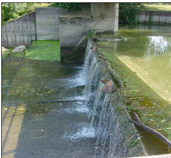
Figure 25 : Photographie du clapet de St Hilaire - St Florent
