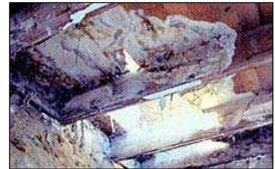
Photo n°1 : Dégâts occasionnés par des champignons lignivores
