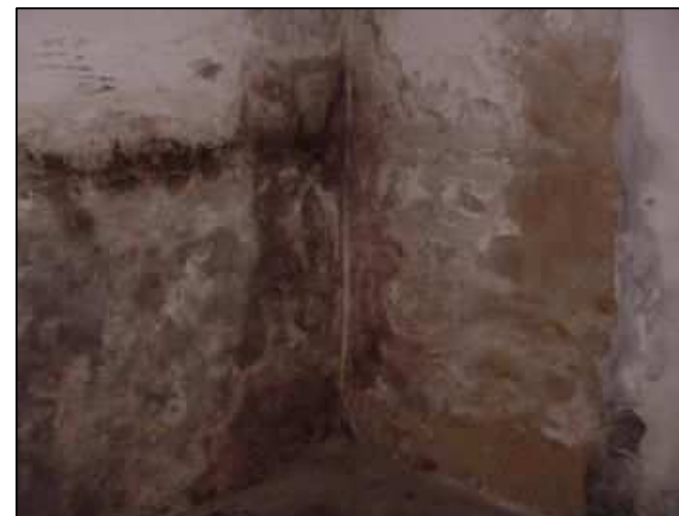
Photo n°5 : Effets occasionnés par l'humidité dans une maison
