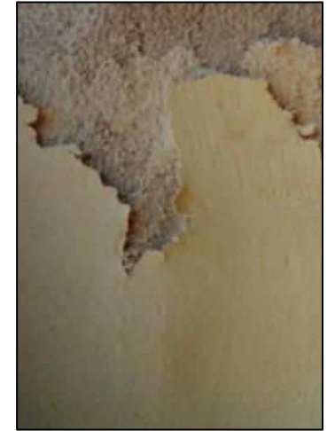
Photo n°4 : Décollement de l'enduit extérieur
