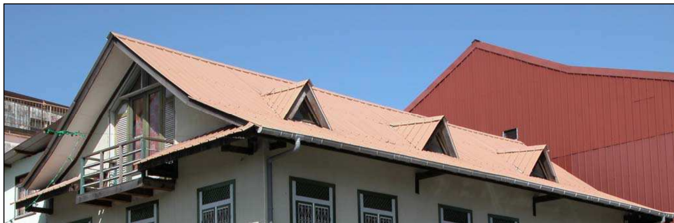
Photo n°33 : Série de outeaux servant d'éclairage et de ventilation à des combles aménagés Source : YVON LENTIN, S.D.A.P.
