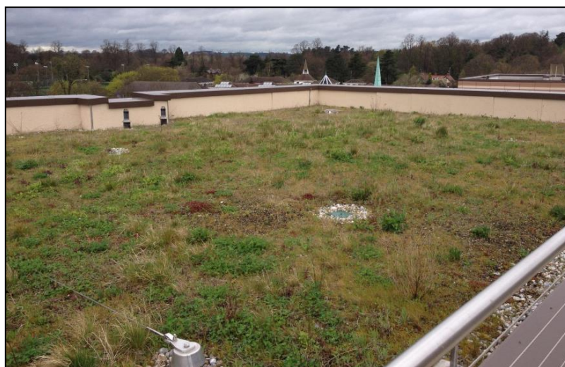
Figure 22 Toit végétalisé de l'hôtel Orchard à Nottingham, Source: bluegreencities.ac.uk
