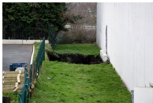
Figure 75 : Effondrement de terrain en mars 2021 à Saint-Etienne Source : France bleu
