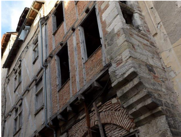
Figure 18 : Bâtiment du centre-ville de Cahors en mauvais état, destiné à être rénové Source : ladepeche.fr
