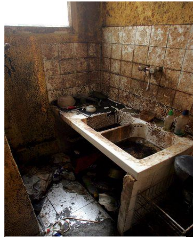
Figure 19 : Logement indigne dans le parc privé cadurcien Source : ladepeche.fr
