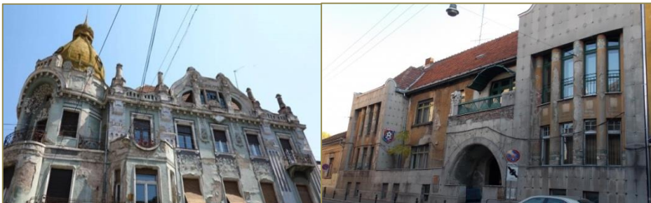
Figure 17- Palais style sécession et palais art nouveau en centre-ville, les deux avec des façades très dégradées. (Source : Florian Lallart & Aline Ferraris)
