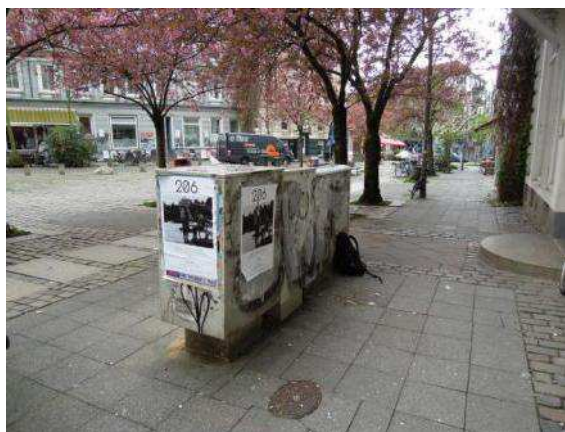
Photographie 6 : Compteurs électriques sur Hein Köllisch Platz, mercredi 09/04/14 à 12H00
