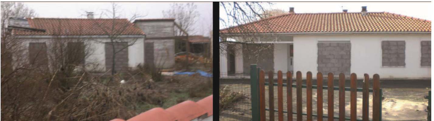
Illustration 2 : Maisons dégradées en zone noire à Charron (Photos : M. Ropert)
