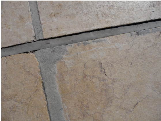
Photo 1 : Les joints éphémères.
