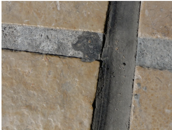
Photo 3 : le joint, à nouveau.
